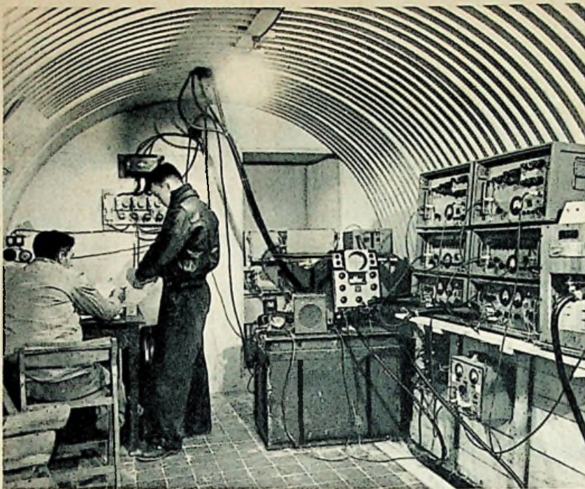
RELAISSTATION TE BLANC NEZ , waarvoor een Duitse bunker als onderkomen diende. De foto toont de draagbaar uitgevoerde contrôle-apparaten, waarvan hier met het oog op de toepassing van „diversity"-ontvangst twee sets.
